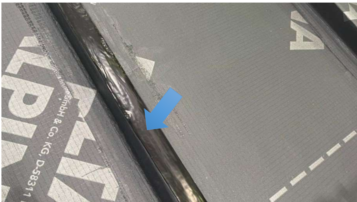
Рис. 11 Нижняя кровля из DELTA-ALPINA, контробрешётка интегрирована в слой гидроизоляции Klasse 1. Уплотнительная лента DELTA-DICHT BAND поверх контробрешётки и гидроизоляции, полная защита от протечек даже через места крепления разрезанного настила.
