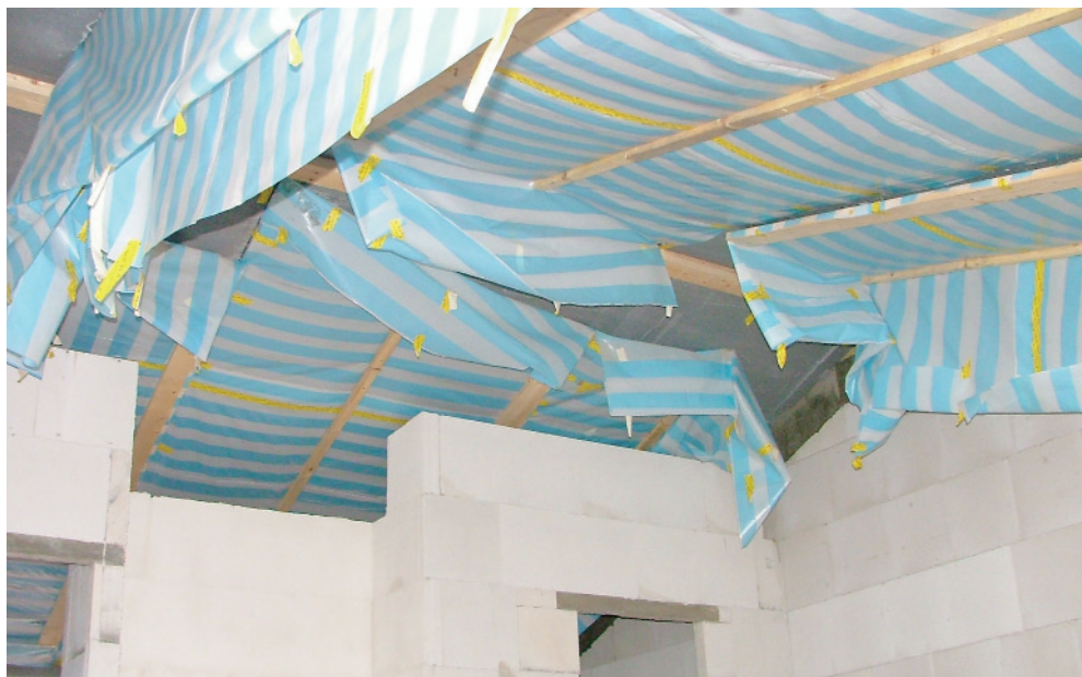
Нахлесты полотен пароизоляции не проклеены лентой
