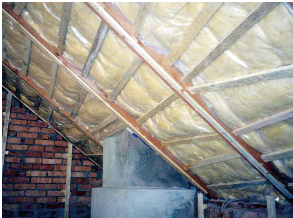
Пароизоляция ошибочно уложена поверх стропил.
